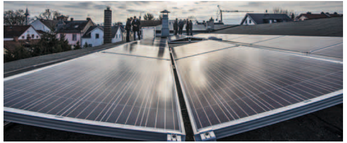
Die Turnerschaft Hedderheim setzt auf die Photovoltaik-Anlage auf dem Dach ihres Vereinsheims.
